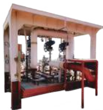
LNG BUNKERING STATION (P&S)
